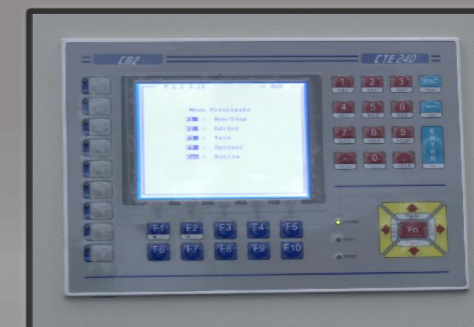
Pannello di controllo
