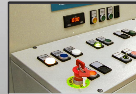
Dettaglio pannello di controllo
